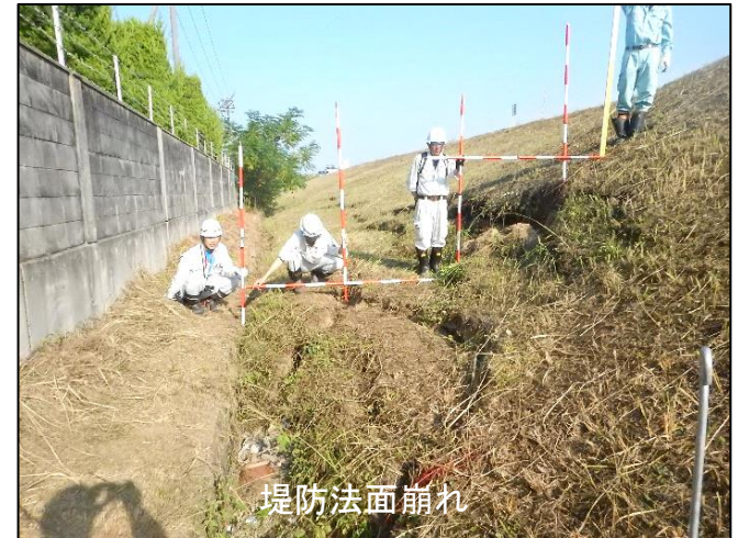
平成29年台風18号 漏水による被災状況
