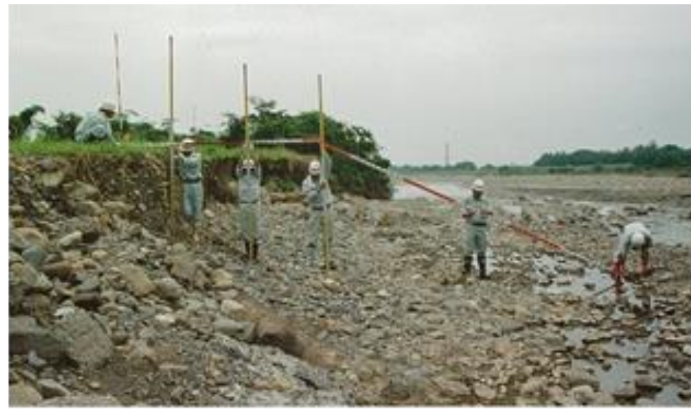
洪水による護岸崩壊(H13.6) (東温市上村地先:重信川河口より14.4km付近 東温市南側)
