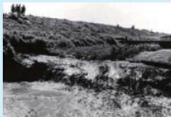
川裏法面漏水
